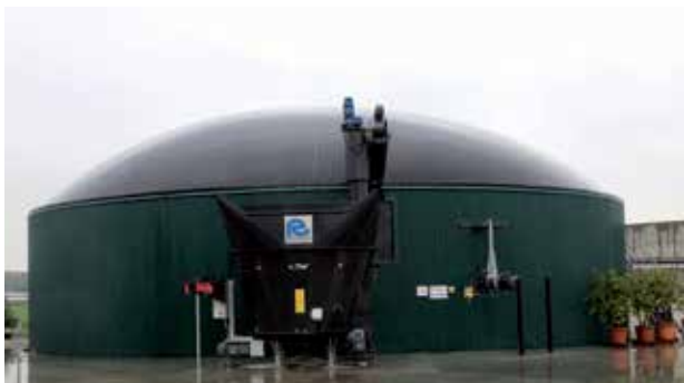
IN ALTO: L'IMPIANTO DI BIOGAS DA 150 KWH CHE HA FORTEMENTE CONTRIBUITO ALLA RISCOSSA ECONOMICA DELL'AZIENDA
