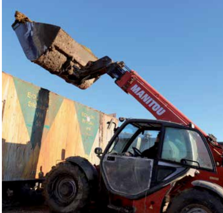
UNA FASE D'ALIMENTAZIONE DELL'IMPIANTO DI BIOGAS
